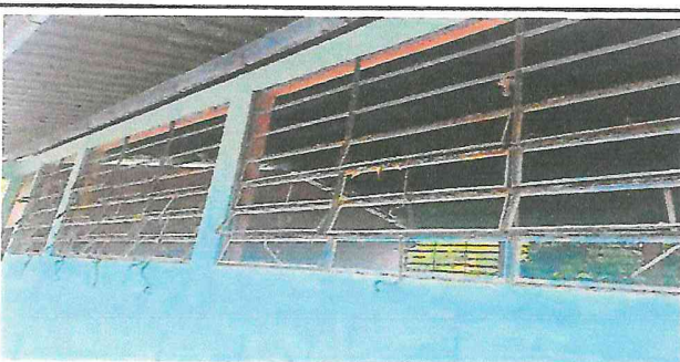
Foto 5: Ventanas sin vidrios.
