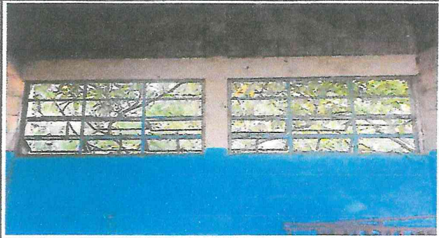
Foto 1: Pintura del establecimiento en mal estado.
