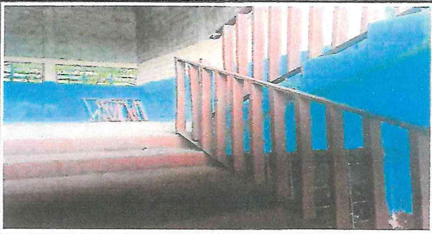
Foto 3: Barandales de gradas en mal estado.
