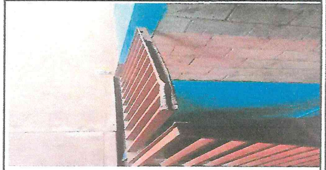
Foto 2: Barandales de segundo nivel establecimiento destruidos.
